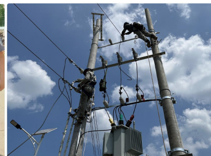
黎明村电力增容项目
